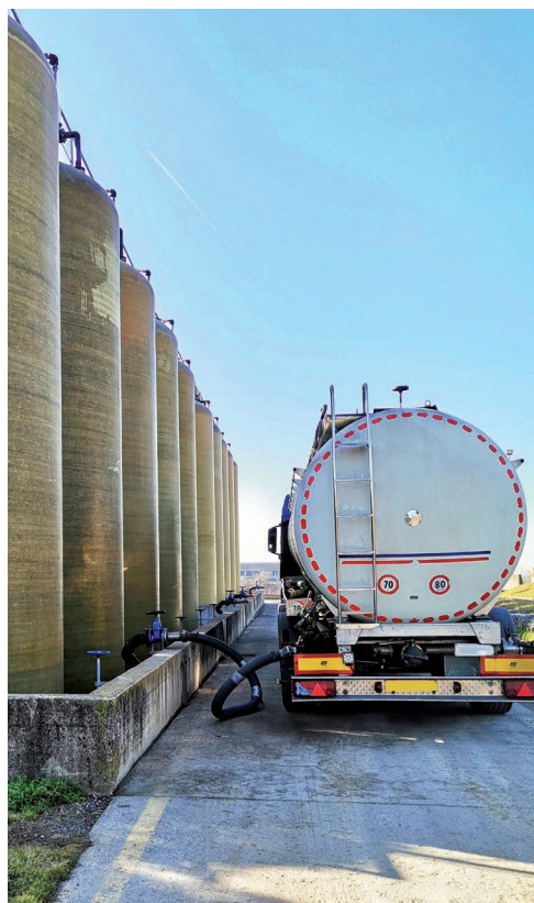
Figura 9.6 - Carico del percolato dai serbatoi di stoccaggio
