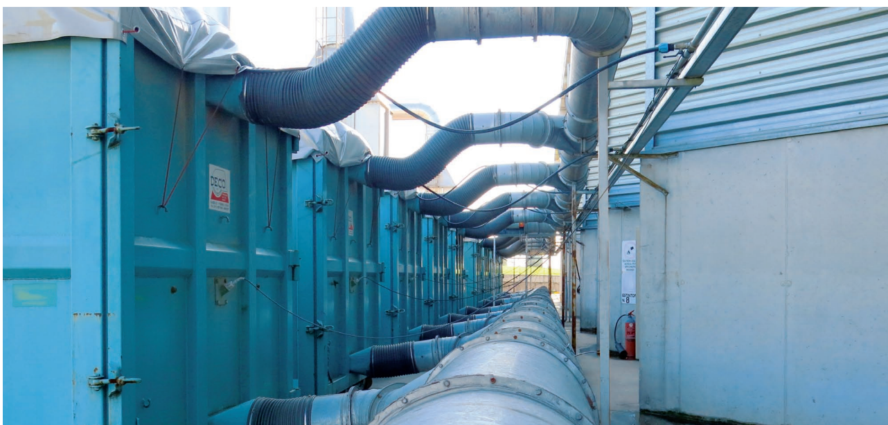
Figura 9.8 - L'impianto di abbattimento delle emissioni aeriformi del capannone di pre-stoccaggio con biofiltri
