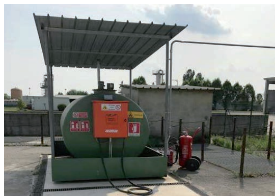
Figura 9-14 – Distributore di gasolio per autotrazione
